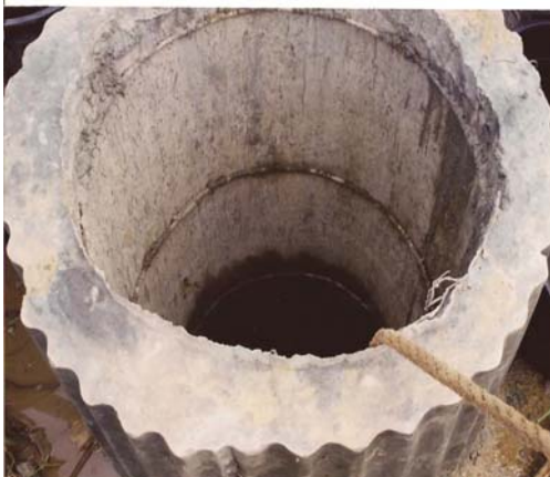
Deep well in Sta. Rita, Pampanga
